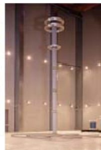
800kV DC MOSA
